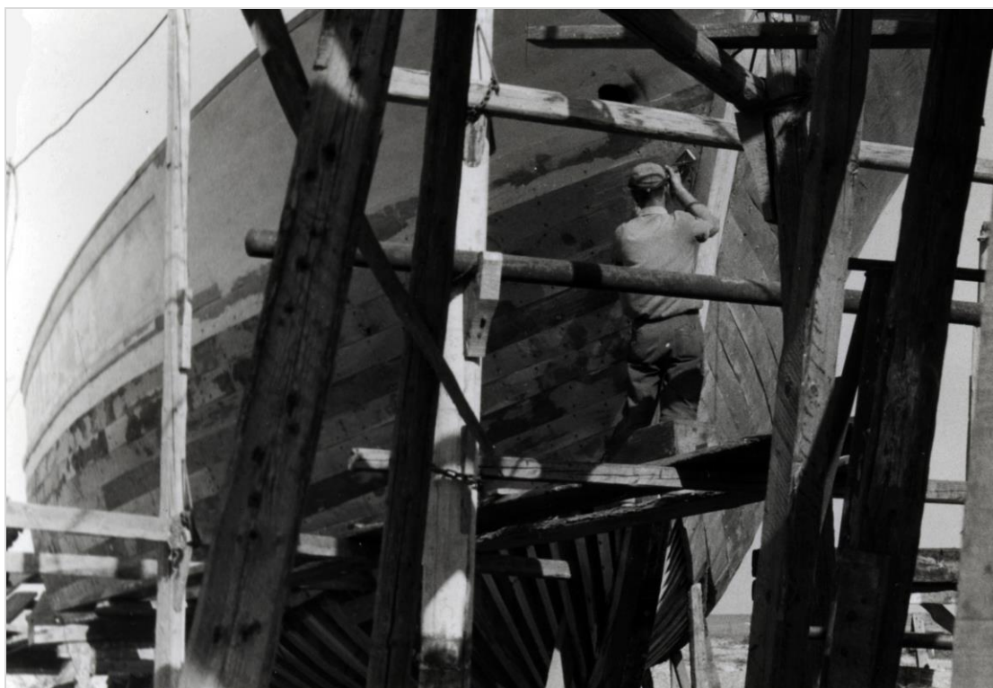
Marzo 1970, cantiere all'aperto nel Porto di Fano. Scafo in legno di un peschereccio in via di costruzione. Il lavoro è complesso: per l'ossatura e il fasciame si usa il legno di quercia e in parte di larice. Dopo aver completato lo scheletro dello scafo ed averlo lasciato a stagionare, si passa alla calafatura, inserendo stoppa nelle fessure e infine catramando la carena
